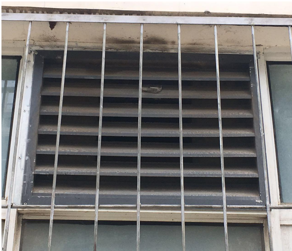
附图 4 焊接过滤系统无组织排放口
